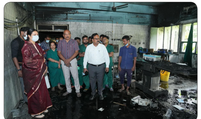
ಆಪರೇಷನ್ ಥಿಯೇಟರ್ ಮಾತ್ರವಲ್ಲದೆ ಅದರ ಸುತ್ತಮುತ್ತಲಿನ ಇತರ ಕೊಠಡಿಗಳೂ ಜಖಂಮಗೊಂಡಿವೆ. ಘಟನೆಯ ಸಂದರ್ಭದಲ್ಲಿ ಸ್ಥಳಕ್ಕೆ ಧಾವಿಸಿದ ಅಗ್ನಿಶಾಮಕ ದಳದ ಸ್ಥಳದಲ್ಲಿದ್ದ ಆರೇಳು ಜನ ಸಿಬ್ಬಂದಿ ತಕ್ಷಣ ಮುನ್ನೆಚ್ಚರಿಕೆ ವಹಿಸಿ ಹೊರಗೆ ಓಡಿಹೋದರು. ಆಸ್ಪತ್ರೆಯ ಜಿಲ್ಲಾ ಶಸ್ತ್ರಚಿಕಿತ್ಸಾ ಕೊಠಡಿಯಲ್ಲಿ ಆವರಣ ಅಂಚೆ ಹಂಚಿಕೊಂಡಿದ್ದಾರೆ. ಆವರಣ ತಜ್ಞ ಡಾ. ಶಿಲ್ಪಾಶ್ರೀ ಅವರು ಮಾತನಾಡಿ, "ಸಾಮಾನ್ಯವಾಗಿ ರೋಗಿಗಳನ್ನು ಆಪರೇಷನ್ ಥಿಯೇಟರ್ ಪಕ್ಕದ ಸಿಡ್ಡು ಕೊಠಡಿಯಲ್ಲಿ ಇರಿಸಲಾಗುತ್ತದೆ. ಈ ಘಟನೆ ಸಂಭವಿಸಿದಾಗ ರೋಗಿಗಳನ್ನು ಇನ್ನೂ ಮುಖ್ಯ ಆಪರೇಷನ್ ಟೇಬಲ್ ಕೆರೆತಂದಿರಲಿಲ್ಲ. ಒಂದು ವೇಳೆ ರೋಗಿಗಳಿಗೆ ಅರಿವಿಲ್ಲದಂತೆ (ಮದ್ದು) ನೀಡಿ ಶಸ್ತ್ರಚಿಕಿತ್ಸೆ ಆರಂಭಿಸಿದ್ದರೆ ಇವತ್ತು ಉಳಿಸಲೂ
